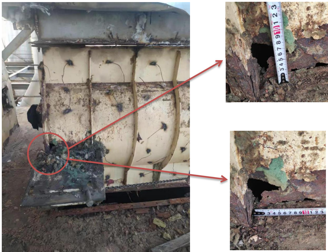
图6 干燥旋风除尘器锁气卸料阀腔体
